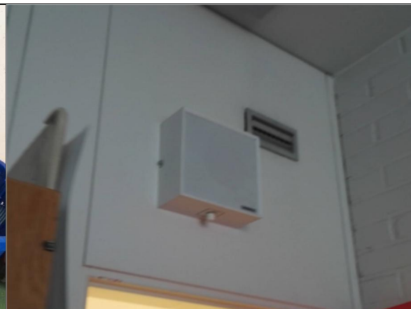
Keskusradion uusittu kaiutin luokkahuoneessa.
