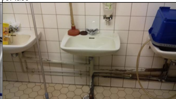
C-rakennuksen kellarin pesuhuoneen vanhat hanat, pesualtaat ja kupariset viemäroinnit
