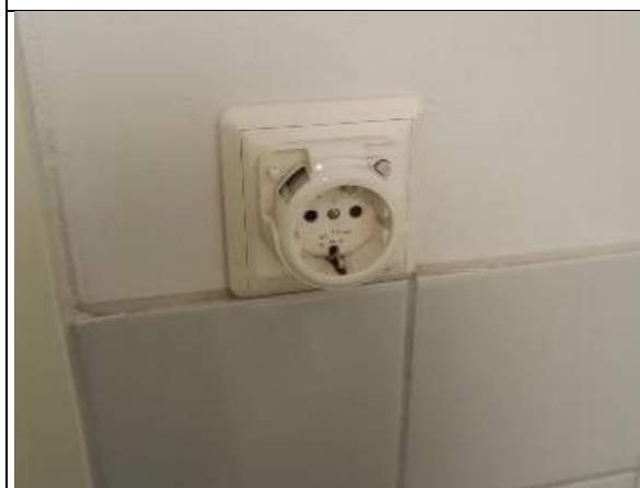
Rikkinäinen vikavirtasuojattu pistorasia.
