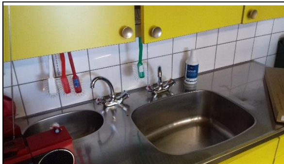
B-rakennuksen terveydenhuollon tiloissa sijaitsevat vanhat kaksiotehanat
