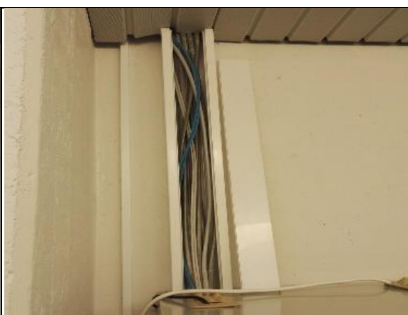
Johtokanavan peitelista irroitettu.
