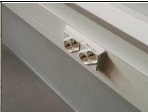
Uusittu maadoitettu pistorasia
