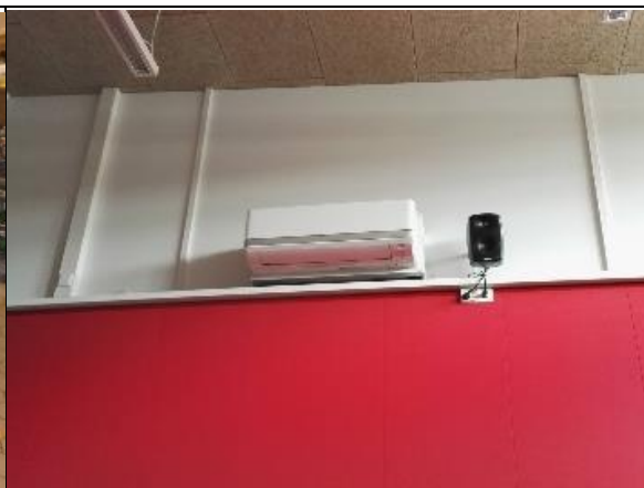
Uusitun musiikkiluokan ilmalämpöpumpun sisäyksikkö.
