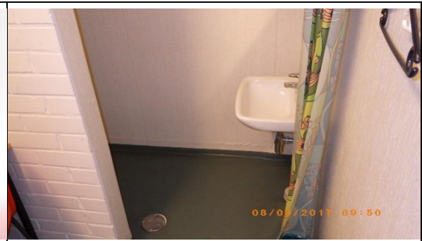
Liikuntasalin opettajien wc/suihkutiloissa havaittiin kosteusvaurioita
