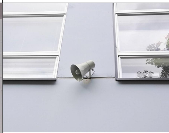
Julkisivuun asennettu torvikaiutin.
