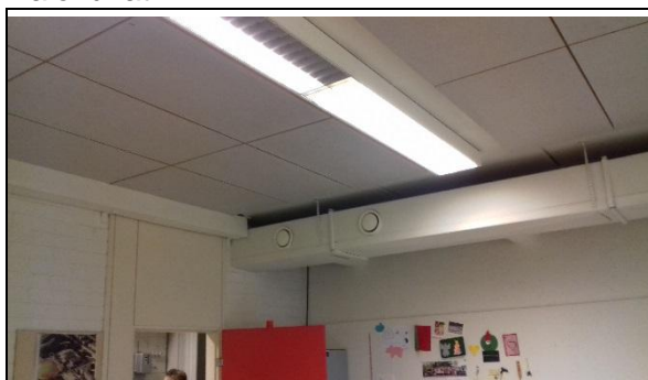
B-rakennuksen tulostushuoneen katossa kulkeva suorakaidekanava
