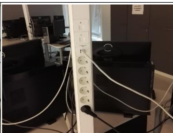
Uusitun luokkahuoneen pylväspistorasia
