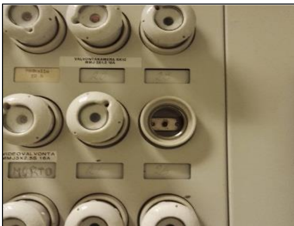
B7-keskuksen puuttuva kosketussuojaus
