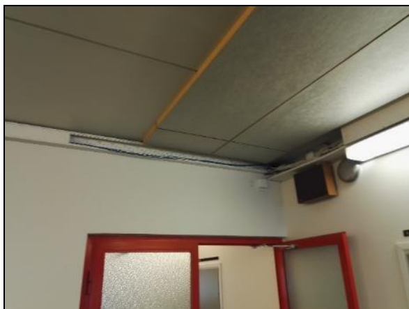
Puuttuvia johtokanavien peitelistoja
