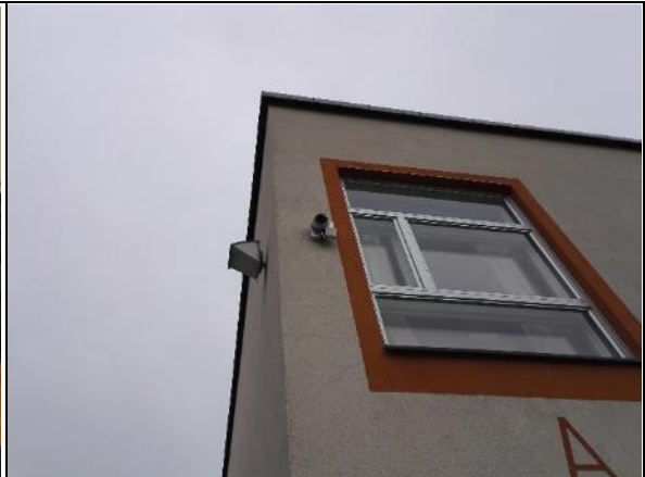
Julkisivuun asennettu valvontakamera
