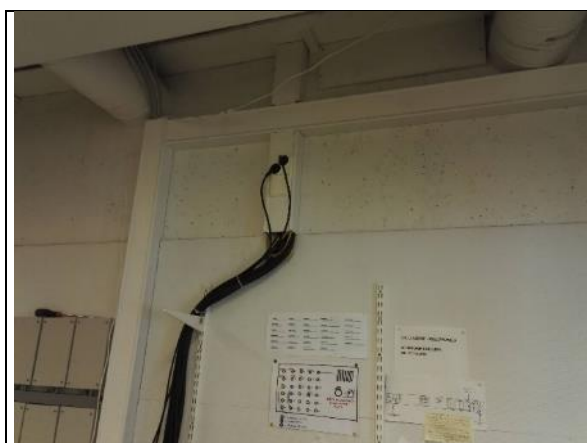
Puuttuvia johtokanavia huoltomiehen huoneessa.
