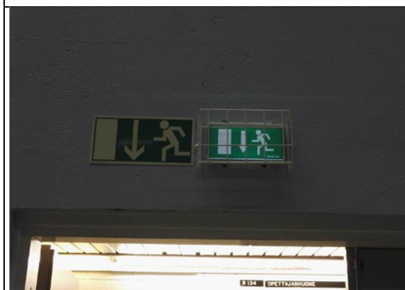
Uusittu opastevalaisin liikuntasalissa.
