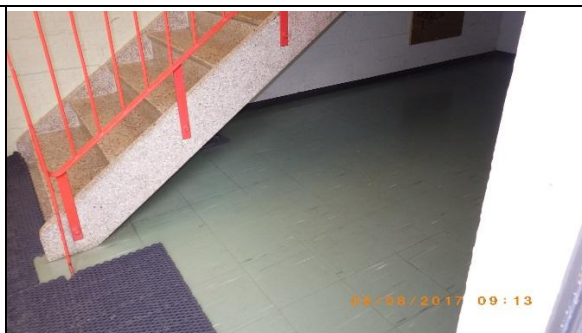
Hammashoitolaan johtavan porrashuoneen alapohjarakenteessa havaittiin pintakosteustarkaste- luissa viitteitä kohonneista kosteuspitoisuuksista. Lisäksi lattiassa oli kopoja vinyylilaattoja.
